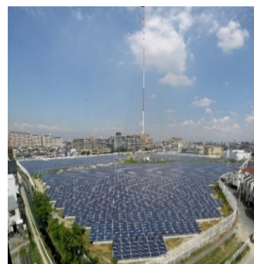
高石ラジオ送信所の太陽光パネル
