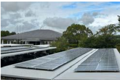
左) 駐車場屋根の太陽光パネル
