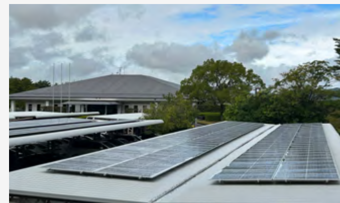
ABCゴルフ倶楽部(駐車場屋根のパネル)
