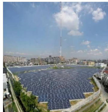
高石ラジオ送信所の太陽光パネル
